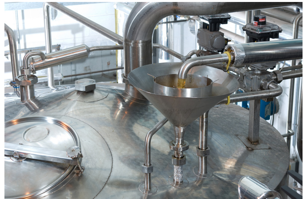
図 2 食品製造設備
